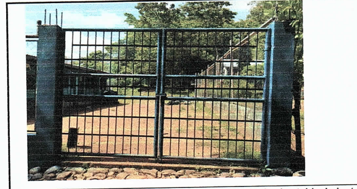
Foto Reparación y reforzamiento del portón de entrada al establecimiento. Y pintura de los muros.
