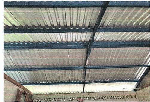
Foto 4: Se realizó sustitución de techo de madera por estructura de metal en las aulas del módulo 1.
